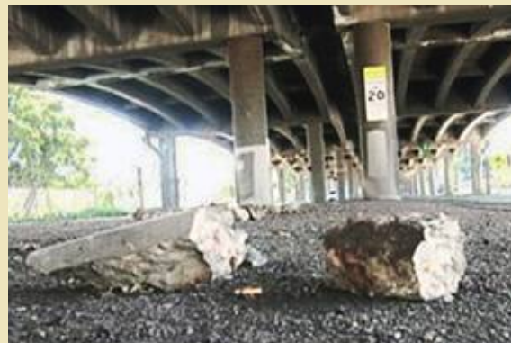
Pedazos de concreto caído muestran un viaducto estructuralmente deficiente. La foto fue tomada en la 46th Avenue debajo del viaducto.
